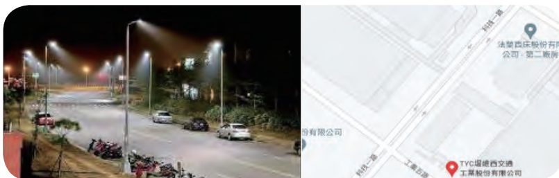
▲認養路燈 - 科技工業區科技一路
